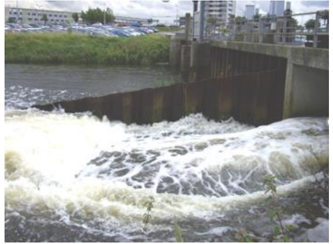
Station de pompage des Pierrettes - Calais
