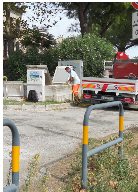
La stazione di pompaggio delle acque reflue di Squero
