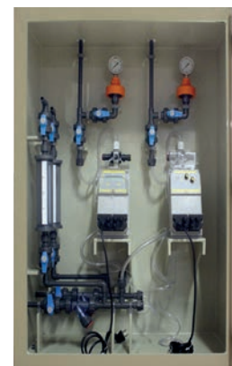
Skid de dosificación
