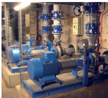
Bombeo de captación
