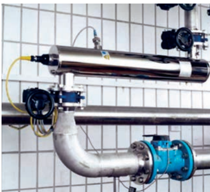
Desinfección de agua ingrediente
