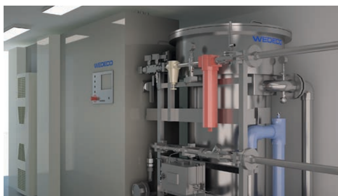
Tratamiento de agua de abastecimiento con ozono
