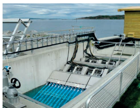
Desinfección UV de agua captación
