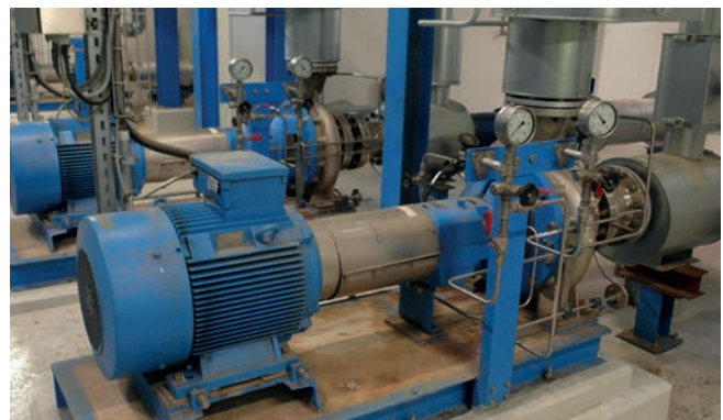
Bombeo de condensados
