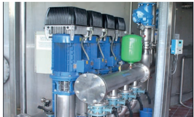
Presurización de agua
