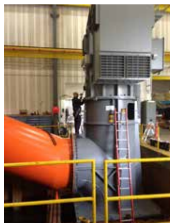
Installation d'essai de Pewaukee
