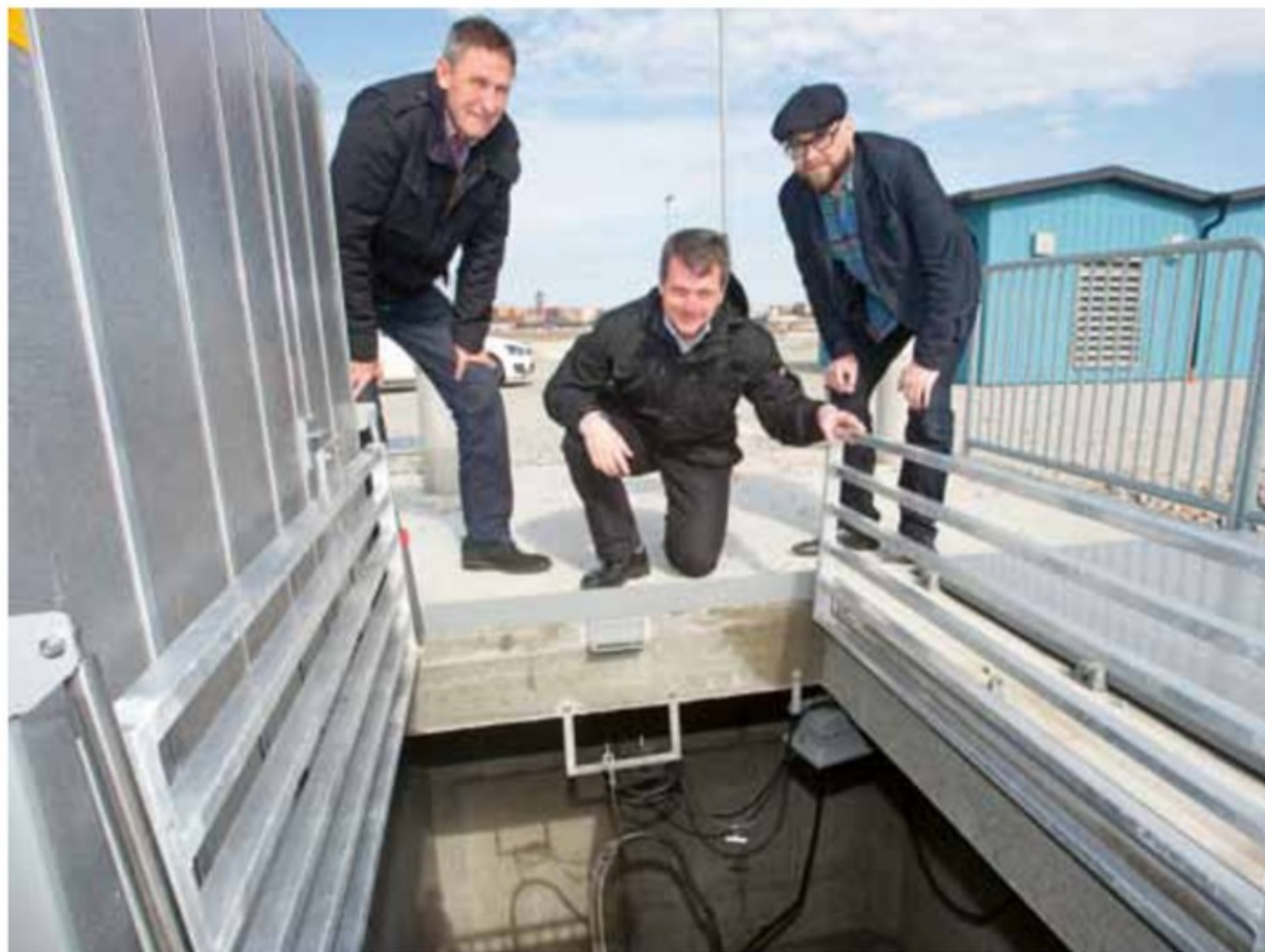
Jan-Åke Persson, Trelleborgs kommun, Patrik Almlöf, Xylem och Daniel Pålsson Wargren, VA-chef i Trelleborgs kommun inspekterar pumpstationen.
