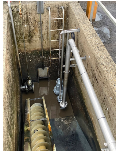
Schacht mit neuer Concertor Pumpe
