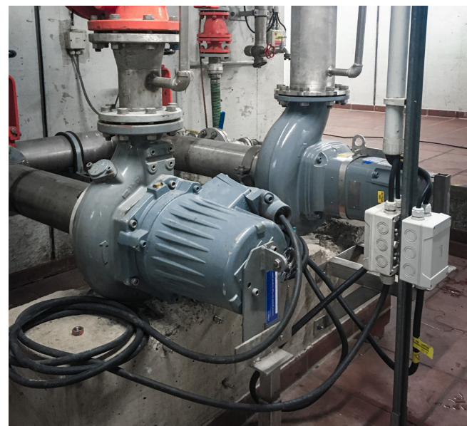
Der erste Einsatz in einer Faulturm-Heizschlammmanwendung für den Flygt Concertor
