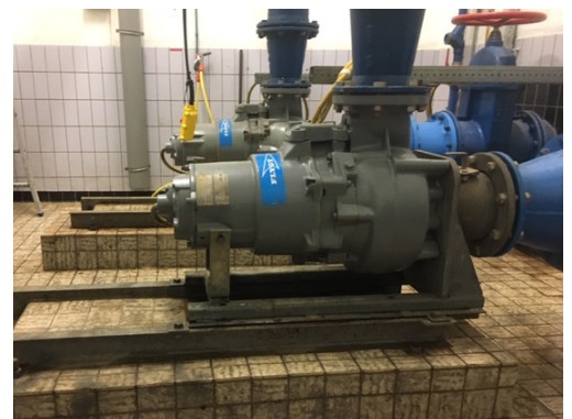
De oude situatie in het gemaal, die voor overlast in de omgeving zorgde door trillingen en resonantie bij het starten van elke pompcyclus.
