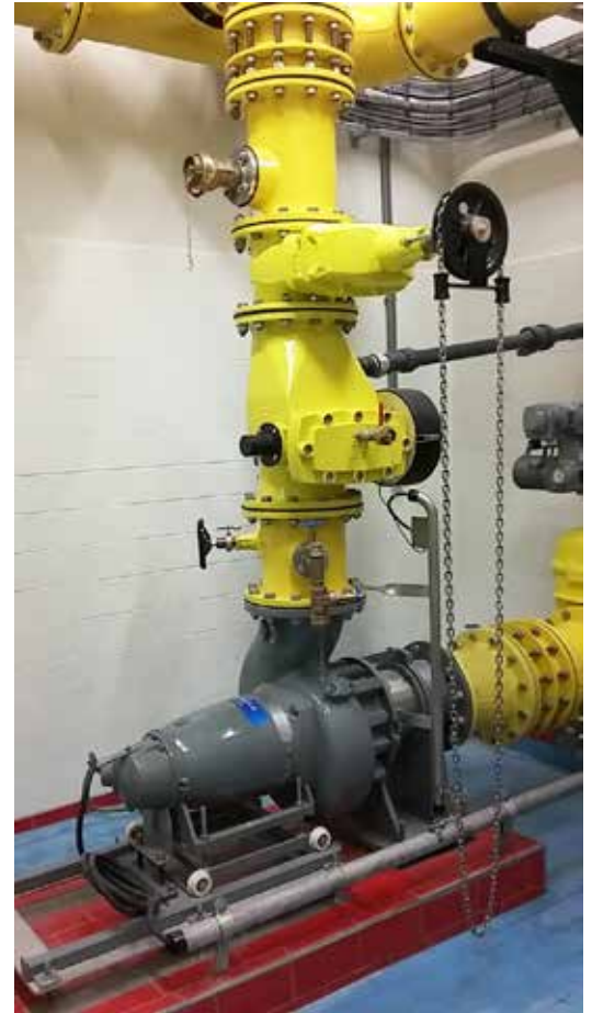
Een close-up van één van de pompen in het rioolgemaal in Rotterdam. De Flygt NZ3153 in een Z-opstelling.
