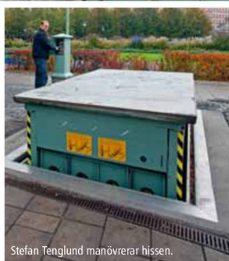
Hissen till pumpstationen kommer upp ur gångbanan utanför Operakällaren. Fr.v: Stefan Tenglund, Stockholms Vatten, Arne Hjort, Evt Umeå och Tomas Ström, Xylem.
