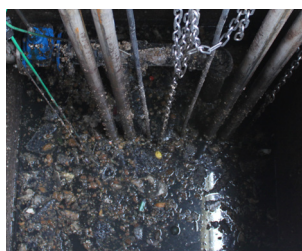
Fig 7 : Bâche de pompage avant installation de Concertor (test client)
